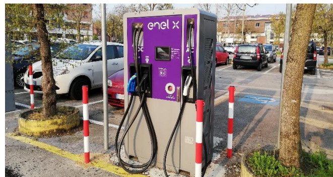
La colonnina dell'area di sosta del parcheggio di via dei Pensieri
